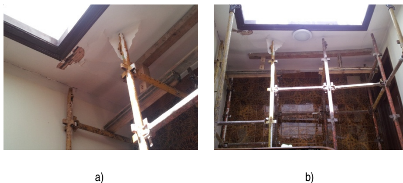
Figura 3.8 – Evidências de degradação na zona da cobertura adjacente à claraboia: a) e b): escoramento
