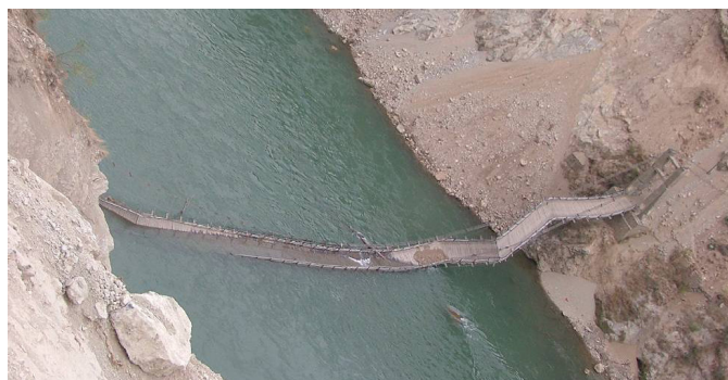
Figura 4.34 – Colapso de ponte suspensa a norte de Muzaffarabad devido ao deslizamento
