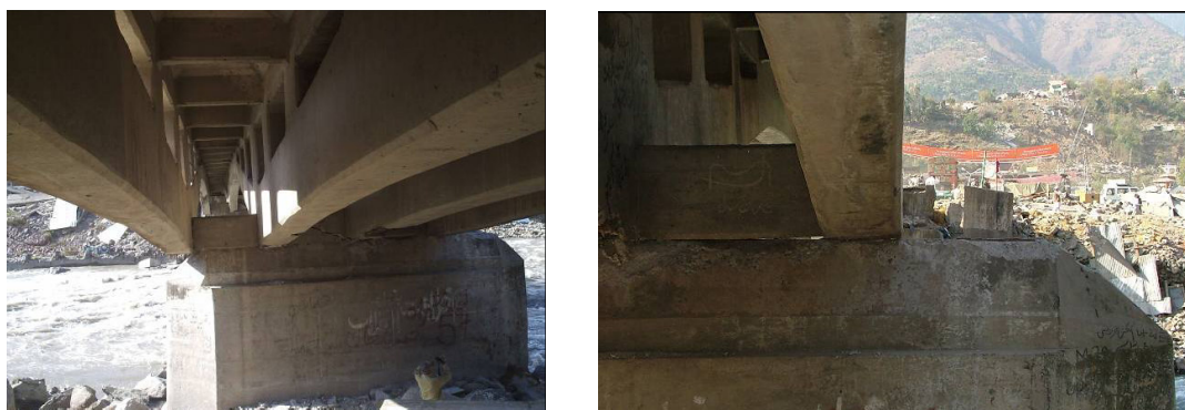
Figura 4.33 – Ponte Balakot sobre o rio Khunar, deslocamento de tabuleiro
