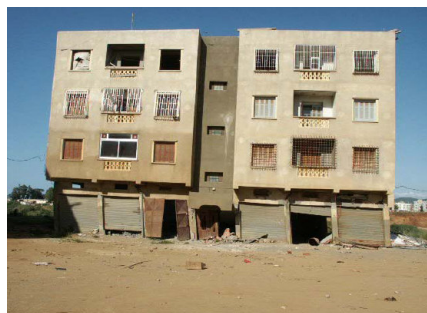
Figura 4.49 – Efeito de soft-storey num edifício residencial com comércio no piso térreo
