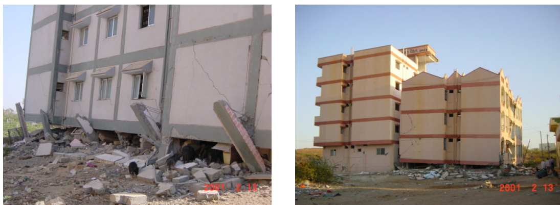
Figura 4.53 – Danos causados por colapso do piso vazado no R/C ( soft-storey )
