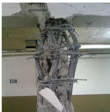
Figura 4.7 – Pilares no estacionamento do edifício Sol Oriente, Santiago, 18 pisos, 300 apartamentos Fonte: EERI Special Earthquake Report, 2010
