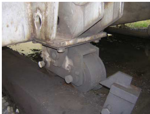
Figura 4.47 – Ligeiro deslocamento do transformador
