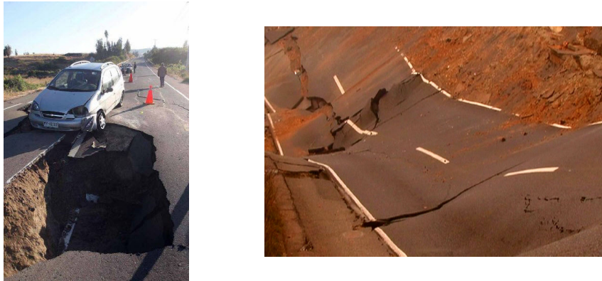
Figura 2.13 – Ruptura da superfície da via. Sismo no Chile, 2010
