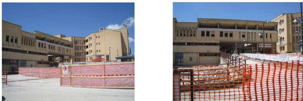
Figura 4.18 – Vista geral da entrada para as urgências com danos estruturais na entrada. Hospital San Salvatore di Coppito
