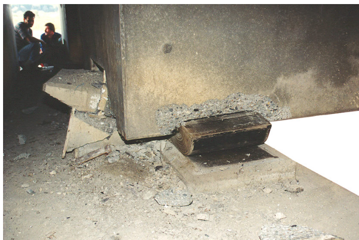
Figura 15 – Deslocamento excessivo num apoio, Turquia, 1999. ( www.koeri.boun.edu.tr )
