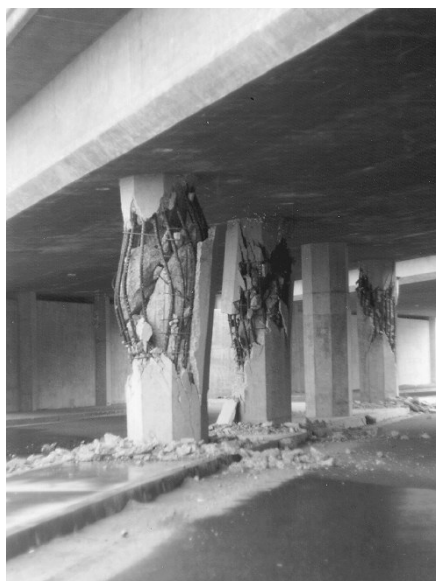
Figura 6 – Reforço horizontal insuficiente, Kobe, 1995. (Chen e Duan, 2003)
