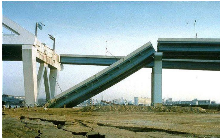
Figura 3 – Rotação excessiva de pilares devido a liquefacção, “Nishinomiya Bridge”, Kobe, 1995. ( www.ce.washington.edu/~liquefaction/html/quakes/kobe/kobe.html )
