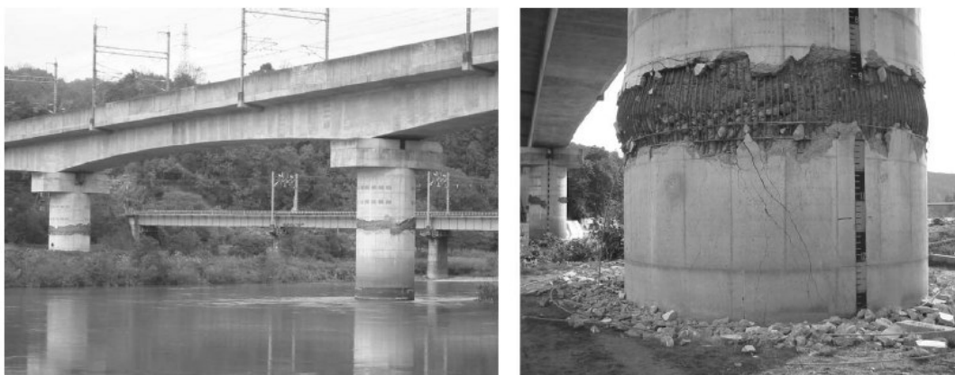
Figura 9 – Danos em pilar ocorridos durante o sismo de Niigata, Japão, 2004. (EERI, 2006)
