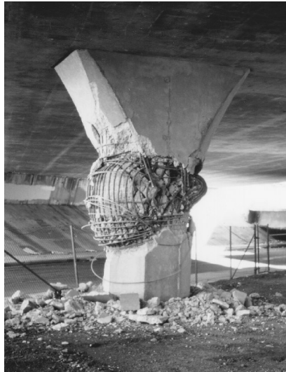
Figura 7 – Rotura por “coluna curta”, Northridge, 1994. (Chen e Duan, 2003)
