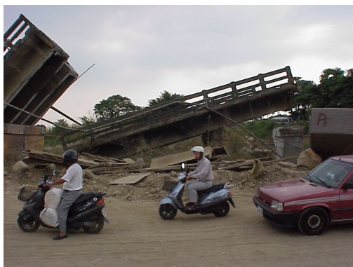
Figura 5 – A rotura da falha ocorreu debaixo da ponte. Ponte “I-Jiang”, Taiwan, 1999. ( http://gees.usc.edu/GEES/ )
