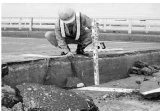
Figura 14 – Assentamento da laje de transição (Wanazu Bridge, Niigata, 2004). (EERI, 2006)
