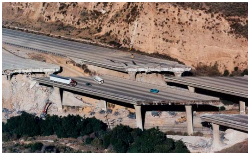
Figura 11 – Viaduto de Gavin Canyon, sismo de Northridge, 1994. ( http://ntl.bts.gov )
