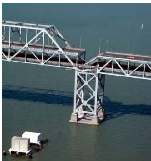
Figura 9 – Deslocamento excessivo num apoio, sismo de Loma Prieta, 1989. ( http://gallery.usgs.gov )
