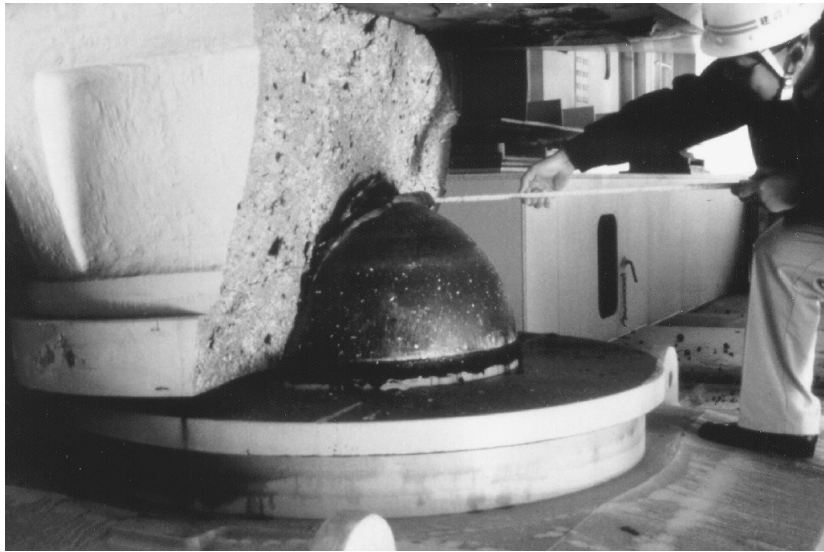
Figura 16 – Ruptura de apoio durante o sismo de Kobe, 1995. (Chen e Duan, 2003)
