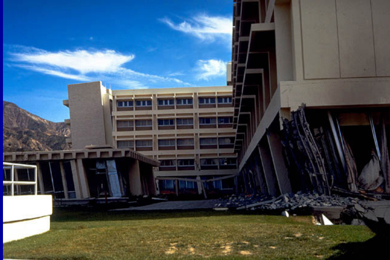
Olive View Hospital, sismo de S. Fernando, 1971. Criação de um soft-storey (descontinuidade vertical de rigidez).
